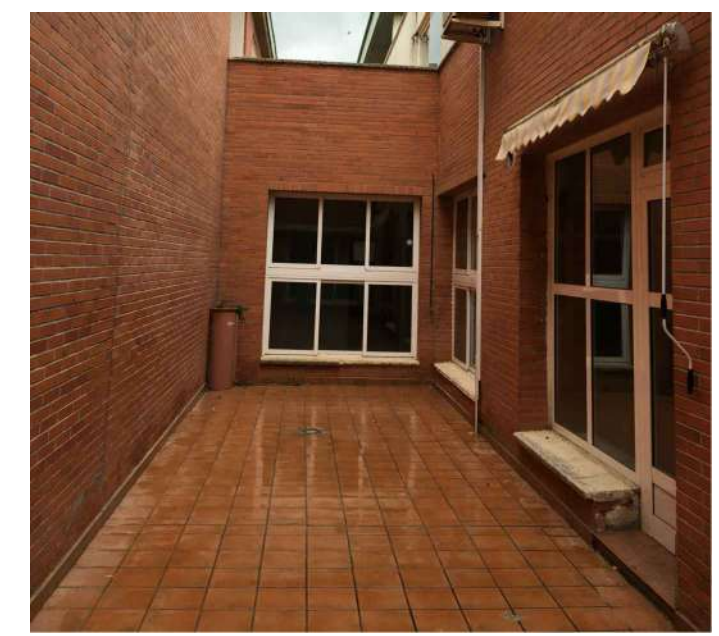
VISTA 02 Patio central, conexión de red de pluviales de ampliación de terrazas.
